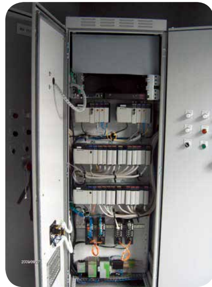
电气室主控制箱
