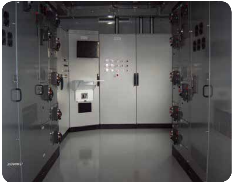
电气室主控制箱和 MCC
