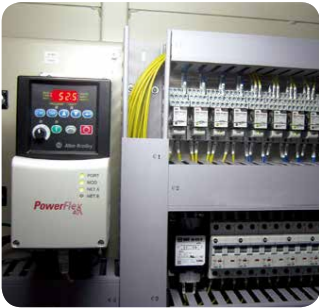
控制面板中的 PowerFlex 40 变频器和继电器。
