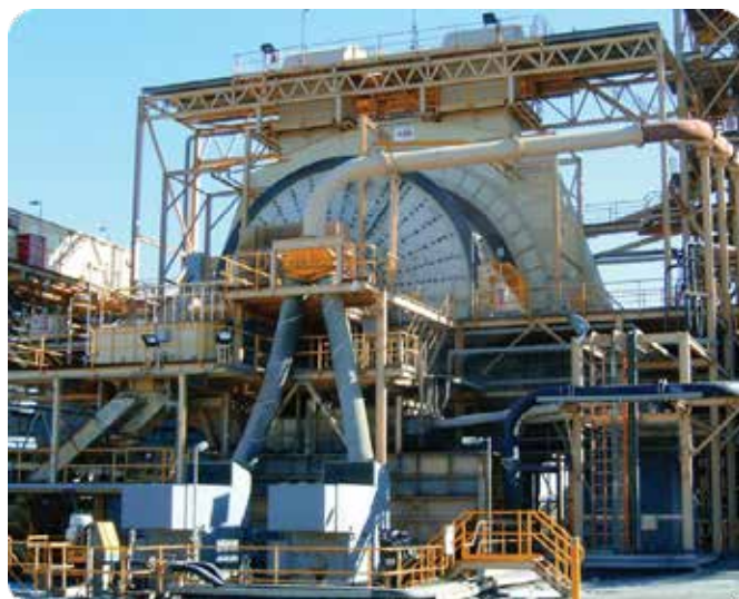
Lefroy 工厂的顶梁柱就是这个直径达 11 m 的半自磨机，它采用了建立在 ControlLogix 基础上的高级多变量控制系统。
