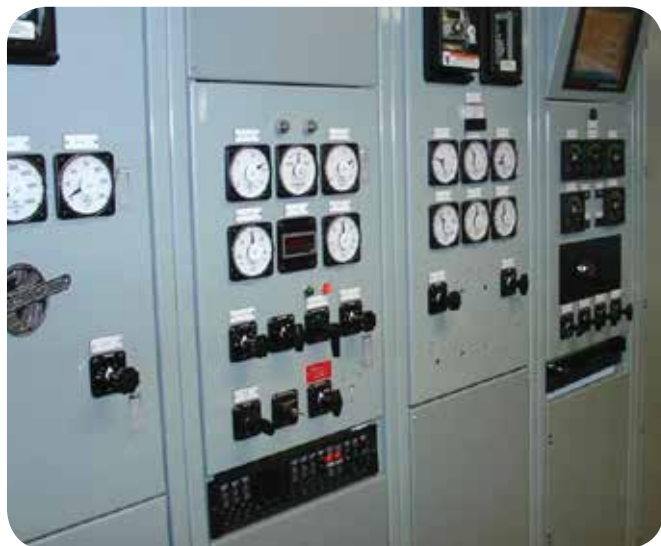
PlantPAx 系统可控制整个工厂，从透平机、锅炉和发电机到水处理、汽轮机和排放系统，以及大部分电站辅助设备应用。
