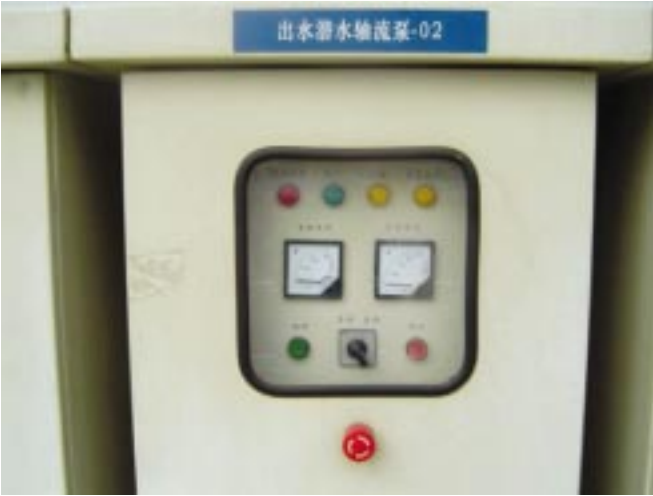
图9 现场操作柜实景图
