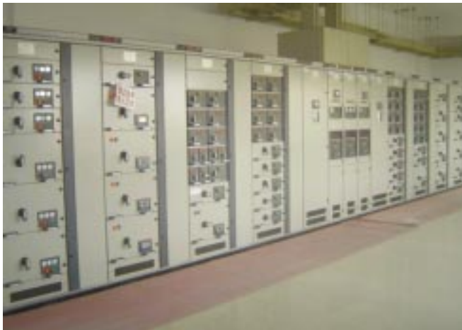
图7 380伏配电柜现场画面
